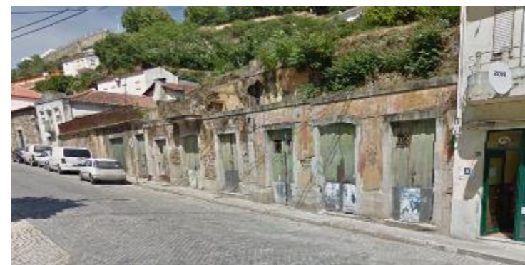
Figura 2 | Parque edificado degradado
